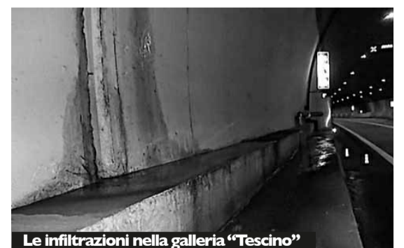
Le infiltrazioni nella galleria "Tescino"
