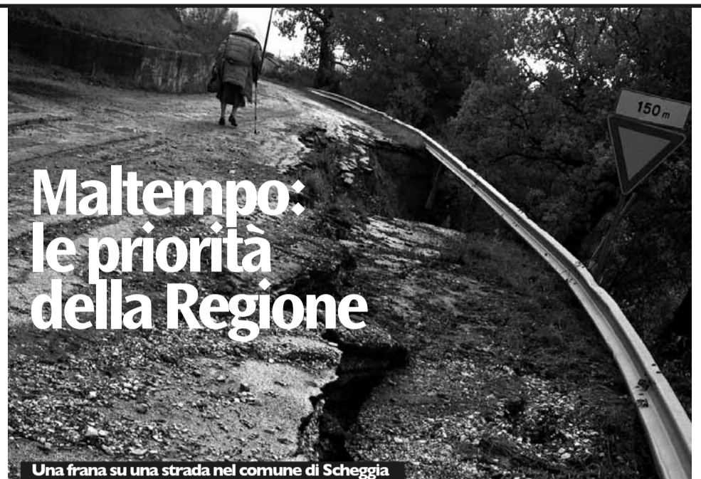
Una frana su una strada nel comune di Scheggia
